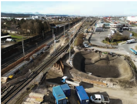
Versickerungsbecken bzw. Retentionsbecken sind Vorgabe im Infrastrukturbau und sammeln Niederschläge kontrolliert.
