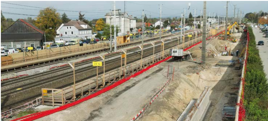
Die Stützmauer für die neue Lärmschutzwand entsteht teilweise hinter der bestehenden Lärmschutzwand.
