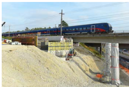
Pfeiler und Widerlager sind fertiggestellt. Als nächstes kommen die Tragwerke über die A25.
