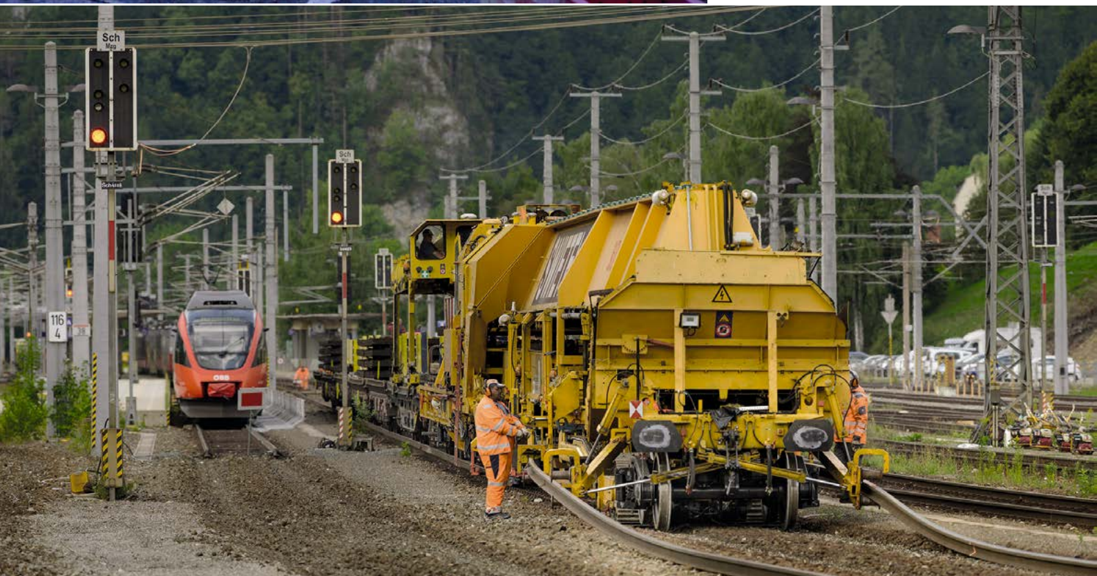
Der Schienenumbauzug war im Sommer 2019 im Einsatz – die meisten Gleise müssen erneuert werden.
