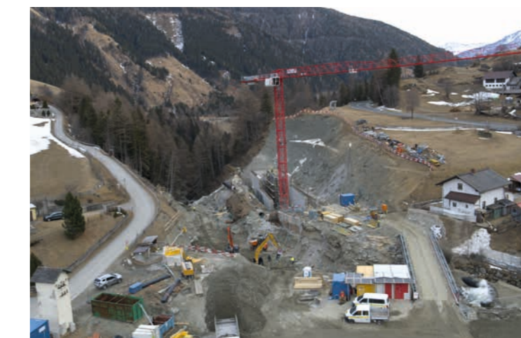
Wasserfassung am Mallnitzbach
