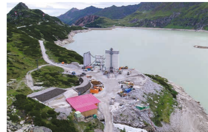
Betonmischanlage am Tauernmoossee
