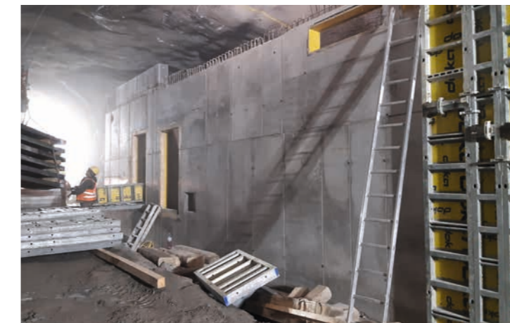
Elektrotechnik-Nische im Zufahrtstunnel
